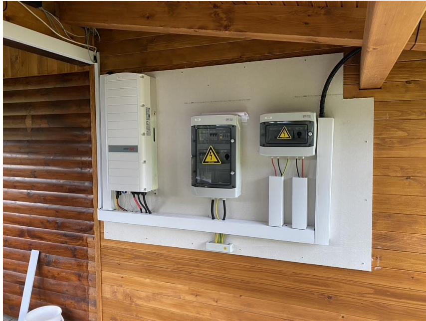
Inverter Solar Edge - RWS
